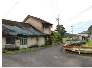
学校近く瓦の落下注意
